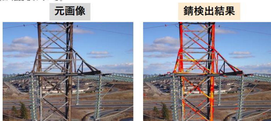
図3.5.4.2 送電鉄塔の点検でのサビ検出例
