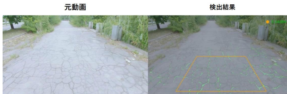
図3.5.4.3 路面のひび割れ検出例
